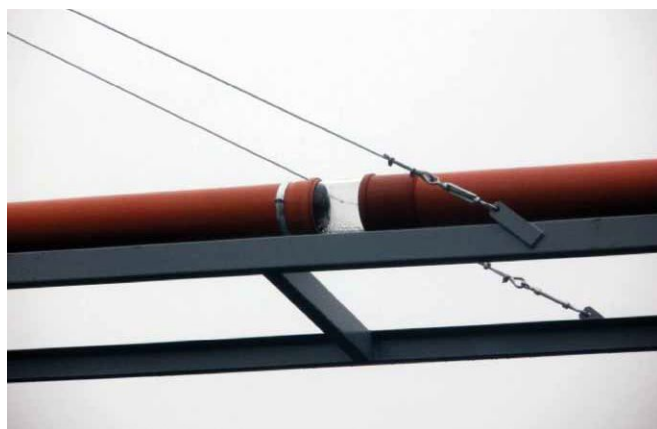
Miejsce kontrolne rurociągu potwierdzające drożność instalacji pneumatycznej
